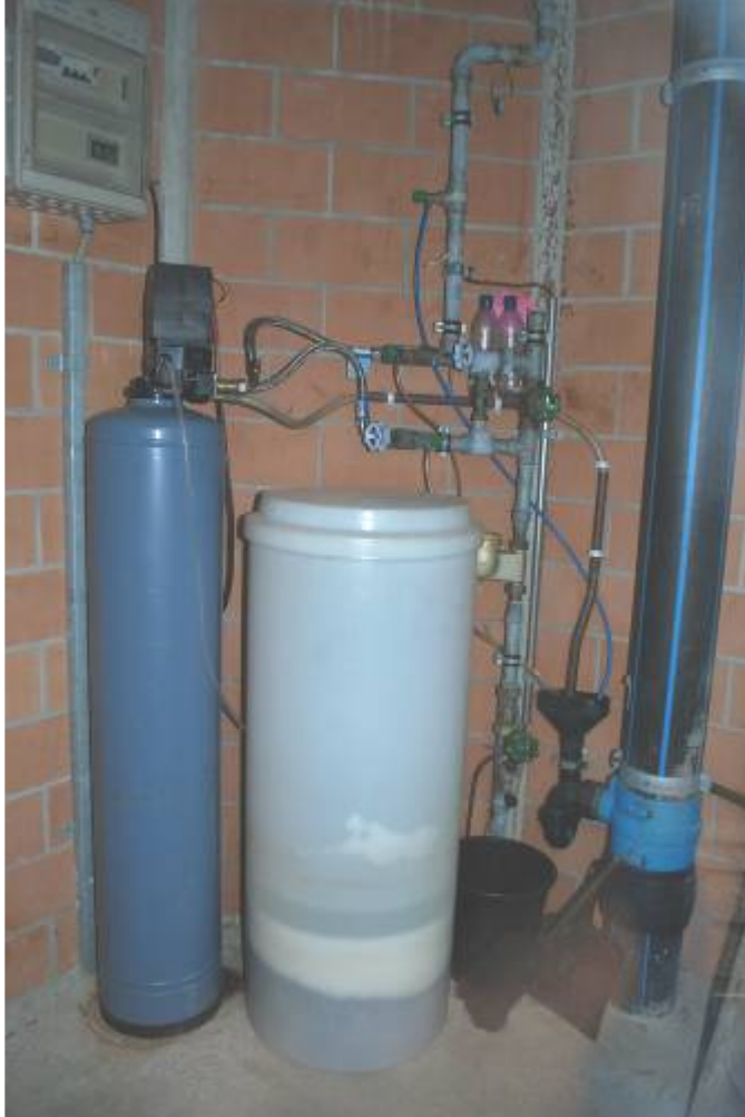
L'adoucisseur d'eau pour les locomotives. Der Wasserenthärter für die Lokomotiven.
