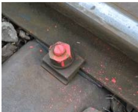
Attache de rail, gravement atteinte par la rougeole.
