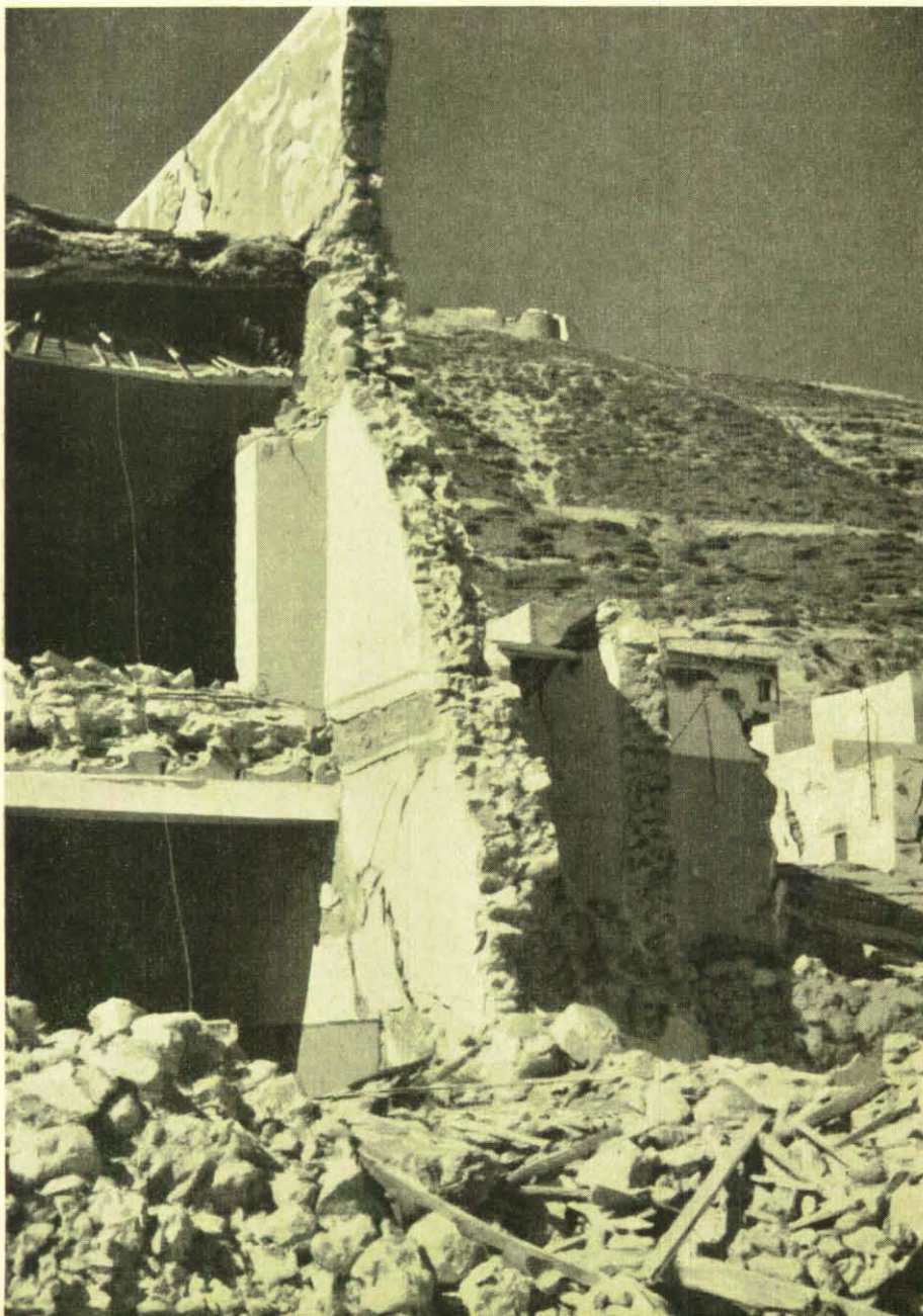
Eine Schadenstelle im Stadtteil Founti, am Fuße der Kasbah: Typisches Lehm-mauerwerk sowie Decken aus Knüppelholz und Lehm wurden fast immer kleinbrockig zersplittert.
