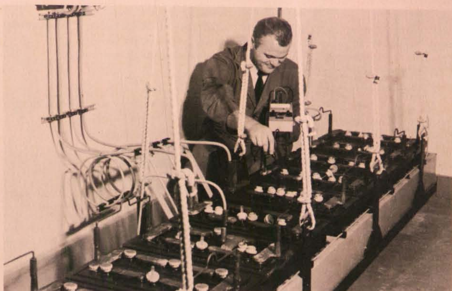
Im Batterieraum des Warnamtsbunkers.
