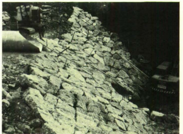
Drei Rohre für den Abfluß bei hoher Wasserführung.
