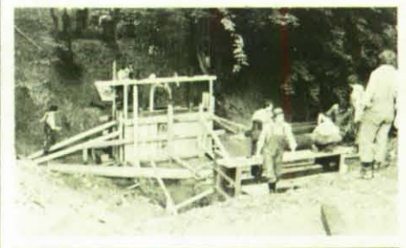
Die THW-Helfer stellen die Joche für die Fußgängerbrücke über den Etschbach auf.
