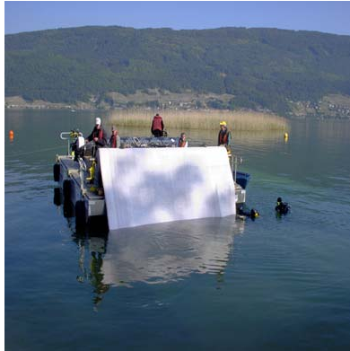
Abb. 3: Sutz-Lattrigen - Hauptstation. Erosionsschutzmassnahmen 2003-2004. Die nahezu 1 t schweren Geotextilmatten können mit dem Spezialschiff verlegt werden. Mit ihm kann auch Kies in einer dünnen Schicht effizient ausgebracht werden. Alle Arbeiten können von der Tauchequipe selbst ausgeführt werden. In der Bucht von Lattrigen sind 6.000 m 2 Siedlungsareal überdeckt und 30.000 m 2 archäologisch untersucht worden.
