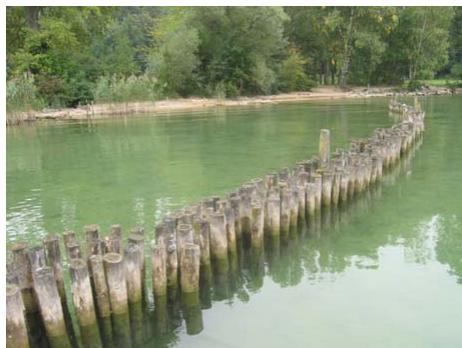
Figure 6 : Photo d'une palissade utilisée sur le Lac de Biemme pour la protection du rivage contre l'érosion.
