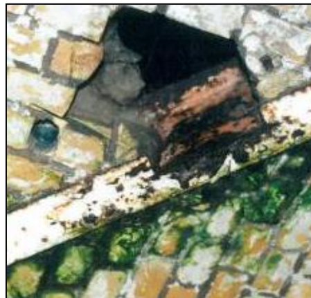
Bild 16: Schlachthof Offenbach, vergleiche Bild 1, Schweinestall; Kappendecke im Schwalbenschwanzverband nach 10-jährigem Leerstand d. Gebäudes
