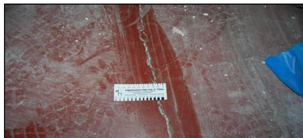
Bild 17: Spannungsrisse im Estrich
