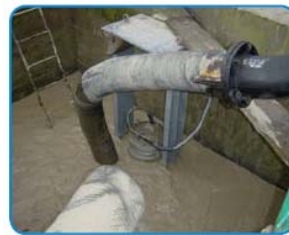
EL60B: Pumpen von Abwasser aus der Marmorindustrie
