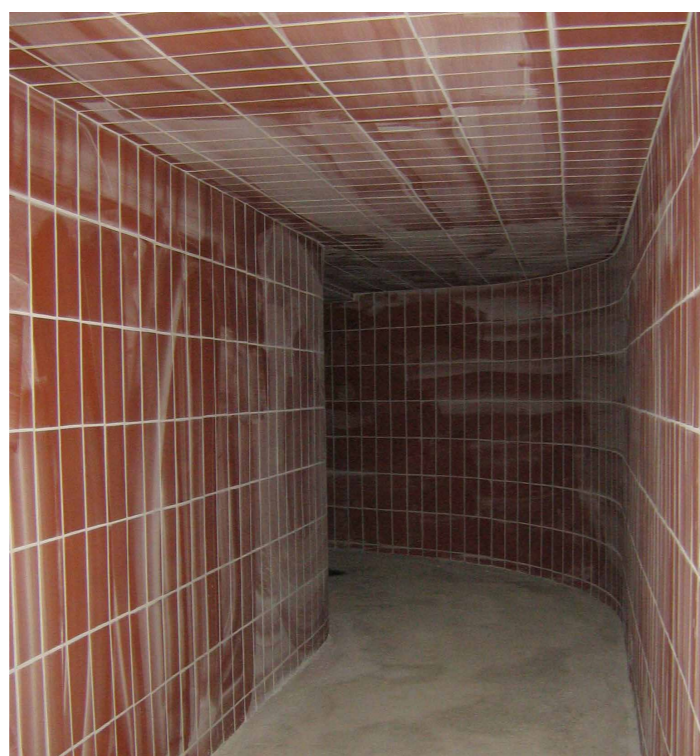
Hartsteinzeug eingesetzt im Klärwerk Koblenz
