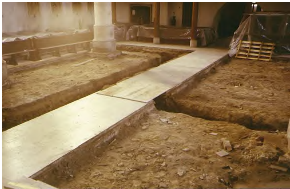
Abb.1: St. Magnus Everswinkel während der Renovierungen Oktober 1977. Blick nach Südwesten (Foto: Pfarrer Ostholt-Wipperfeld).
