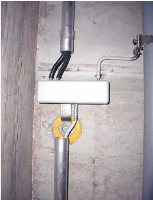
Bild 1: Haupterdungsschiene und Potentialausgleich
