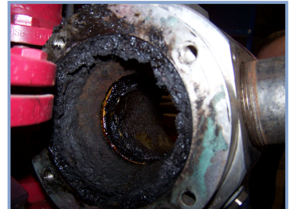
Teerablagerungen am Gas-Luft-Mischer
