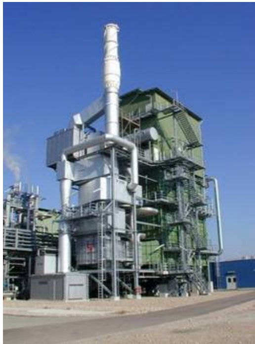
Abb. 11: Linde-Erdgas-Dampfreformer mit CO-Konvertierung, Gasreinigung per Druckschwingabsorption (PSA), Kapazität: \text{H}_2 35.000 \text{Nm}^3/\text{h} , Reinheit: 99,99 mol %
