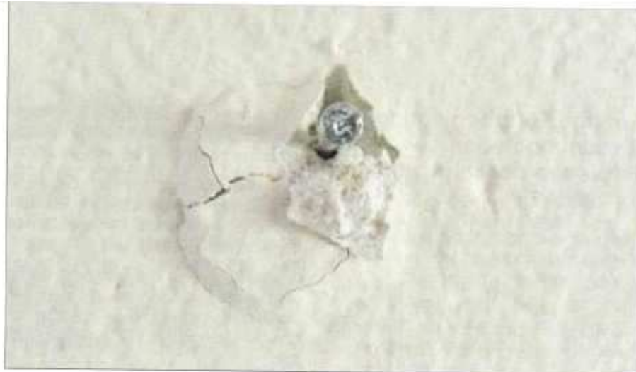
Nageltest mit ausbrechender, spröder Putzzone und Anstrich
