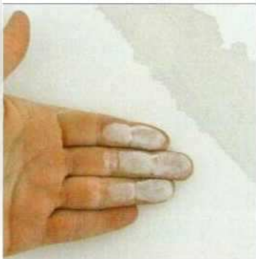
Mehlender Putz unter dem Anstrich
