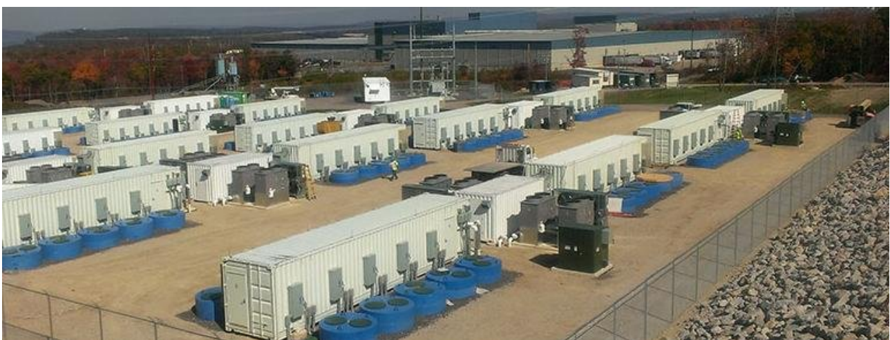
Abb. 9 : Das Flywheel-Speicherwerk von Beacon-Power in Hazle Township, Pennsylvania besteht aus 200 Schwungradspeichern und leistet 20 MW für den Frequenzgleich des Netzes, Inbetriebnahme war 2014 ( www.beacon-power.com )
