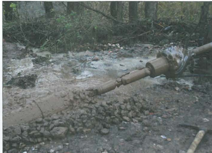
21 Bohrkopf mit angehängter PE-Leitung beim Einziehen in die Bohrung Foto: E. Ehr
