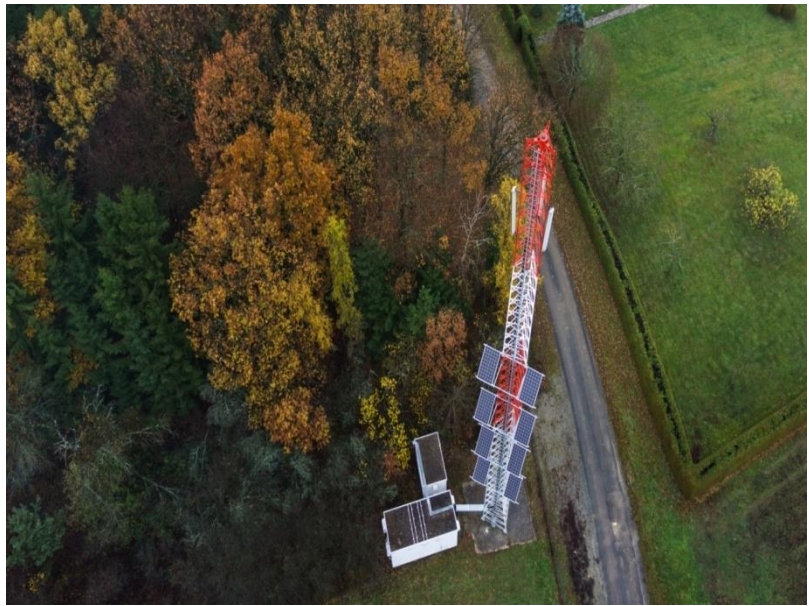
Foto von A1 Telekom Austria : Photovoltaikpaneele am Richtfunkmast in Oberwart
