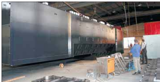
Schwerarbeit war es, den letzten und schwersten Brocken der späteren Schwimmbaggeranlage durch das Tor der Mannschott-Halle zu lenken und auf den Tieflader zu hieven. Foto: Barth
