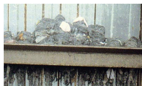
Abb. 39 Rechengut Quelle: Informationsbroschüre zum Klärwerk Ruhleben, Berliner Wasserbetriebe
