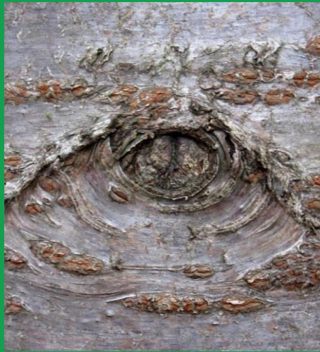
Augen-förmige Risse (Astloch)
