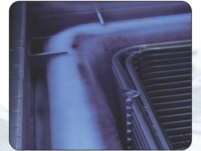
Eisbank einer Eiswasseranlage
