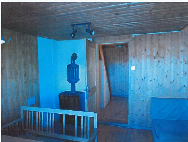
Holzofen in Aufenthaltsraum im 1.OG
