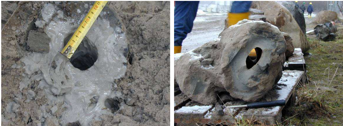
Bild 9: DSV-Kerzen mit Hohlräumen
