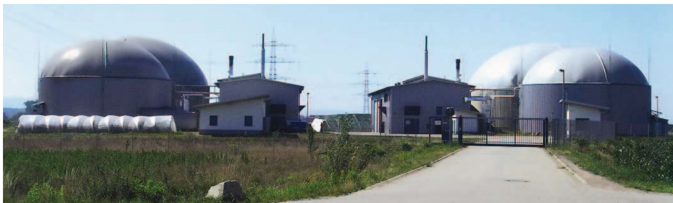
Abb. 3.7-1: Biogasanlage Neuried der Fa. badenova AG & Co. KG (jeweils 2 baugleiche Einheiten)
