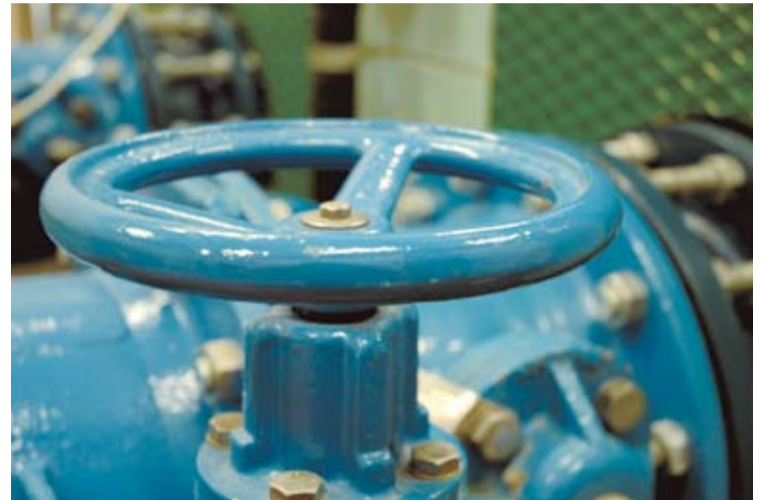
Einblick in ein Wasserwerk: Jedes Rädchen und jedes Ventil zählt.
