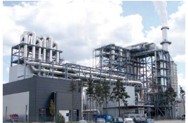
Das neue Werk in Baruth – im Süden von Berlin, unweit des Spreewaldes. Hier kamen durchdachte Lösungen von Schneider Electric zum Einsatz.
