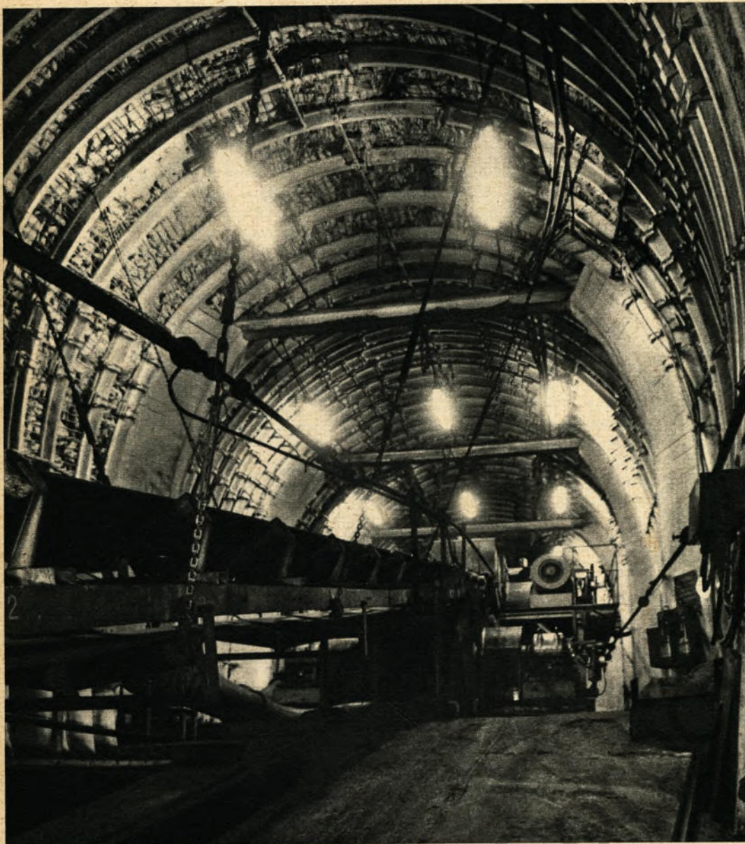
◀ So endet das Band in der oberhalb der 7. Sohle liegenden Antriebskammer, die beachtliche Ausmaße hat: sie ist 17 Meter lang, 8 Meter breit, 7,20 Meter hoch und hat einen lichten Querschnitt von 50 Quadratmetern
