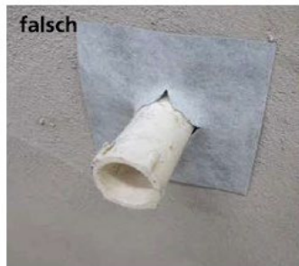
falsch Die Dichtmanschette wurde eingeschnitten, um sie über den Baustopfen stülpen zu können.
