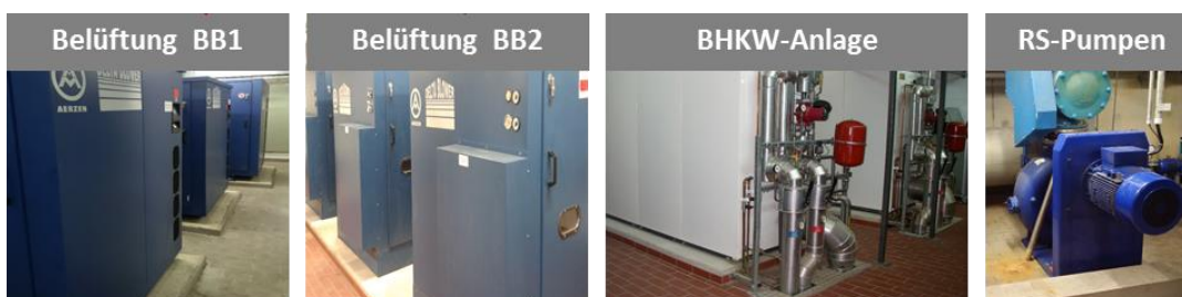
Bild B.4.55: Doppelhub für alle vier technischen Einheiten auf der KA Radevormwald
