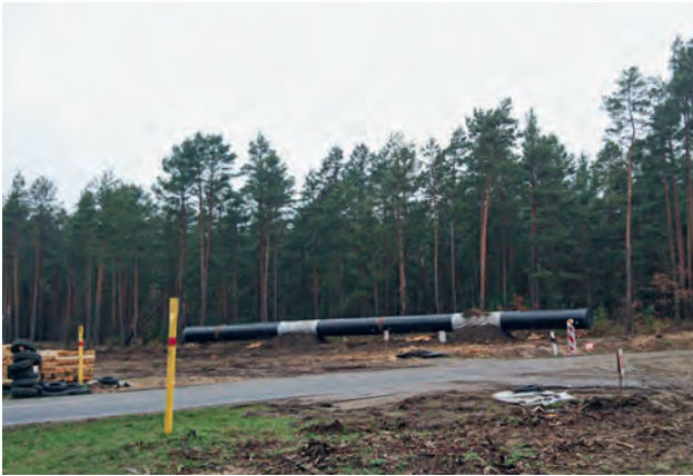
Abb. 11 Zerstörung des Waldrandes durch den Bau der EU-GAL-Trasse 2019
