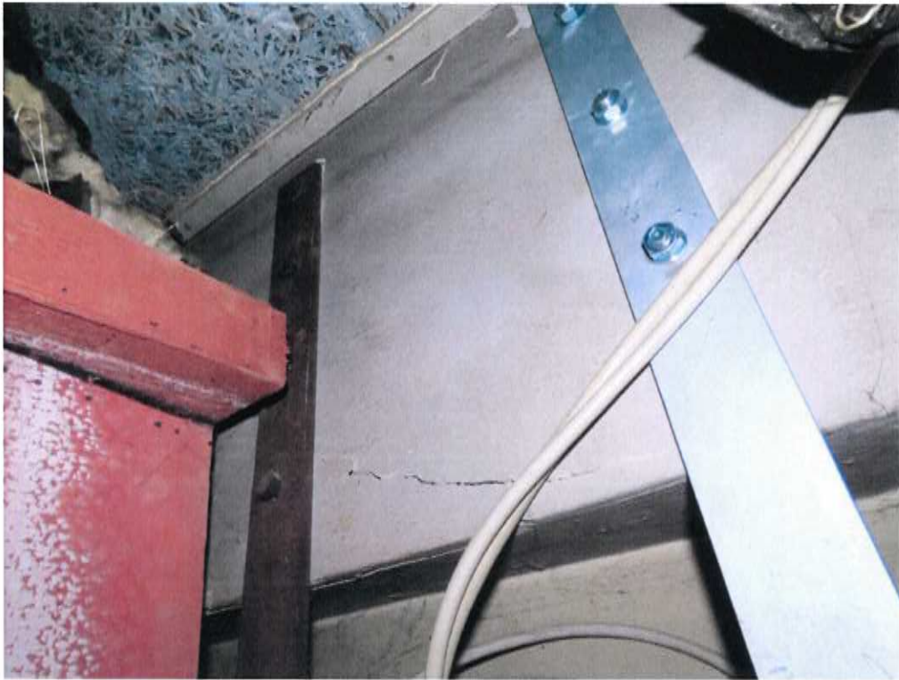
Foto 41: stählernes Lagerprofil: zwischenzeitlich ergänzte Verstärkung durch Zusatzaufhängung
