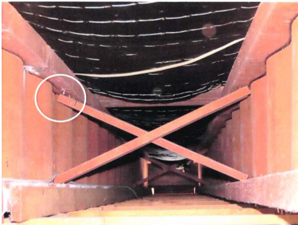
Foto 16: Holz-Wellstegträger: unsachgerecht angeschlossene Auskreuzung zwischen Trägern (evtl. als Montage-Provisorium, exemplarisch); exzentrische Aufhängung der abgehängten Decke über je ein seitlich angenageltes Brett (am linken Wellstegträger) erkennbar
