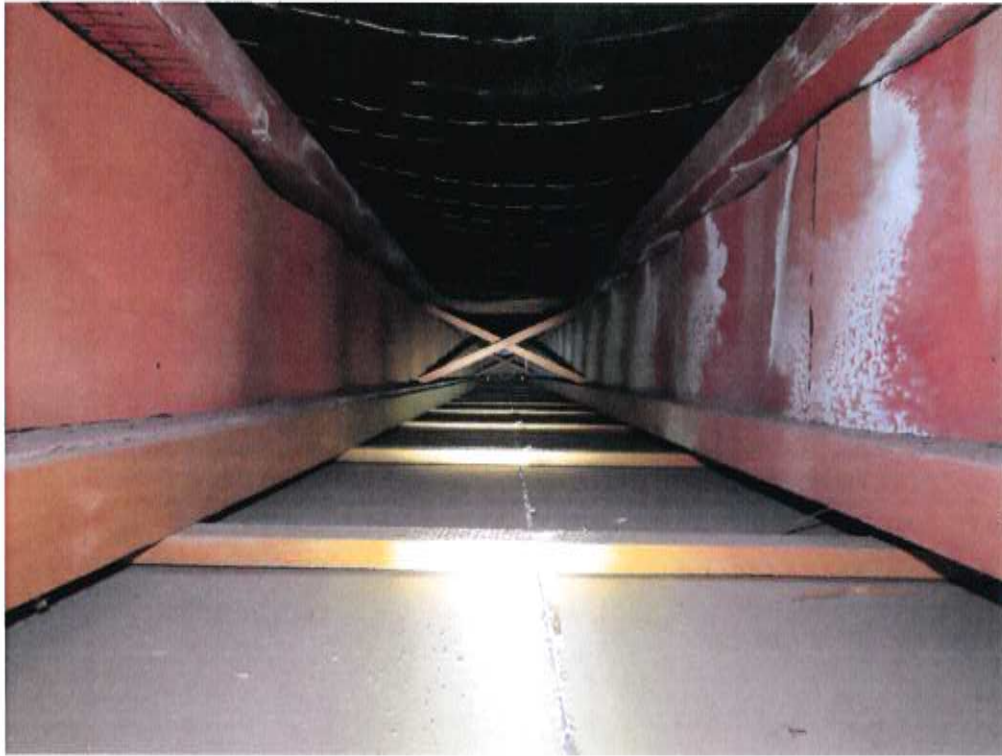
Foto 39: Holz-Wellstegträger: Detail flächige Aussinterungen / Salze auf den Holzoberflächen (exemplarisch)
