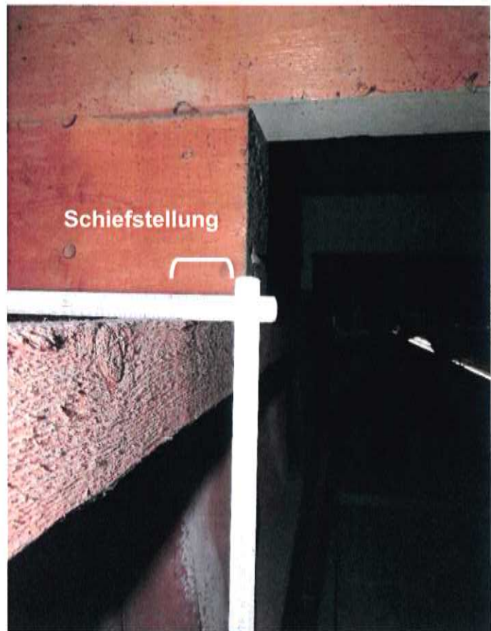
Foto 13: Holz-Wellstegträger: exemplarische Messung der Schiefstellung im Bereich der Bühnentechnik ( > 35 \text{ mm} bzw. > 4^\circ bezogen auf die Trägerhöhe von 47 \text{ cm} )
