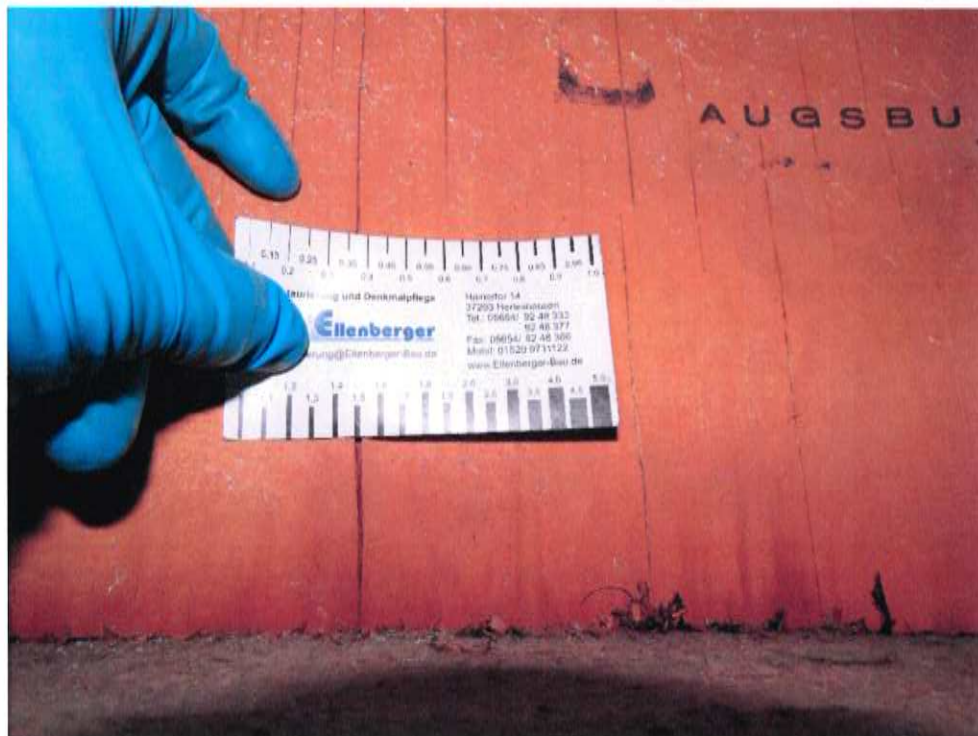
Foto 30: Holz-Wellstegträger: Detailaufnahme zu Fotos 28 und 29 mit Vertikalriss 1,5 mm (exemplarisch)
