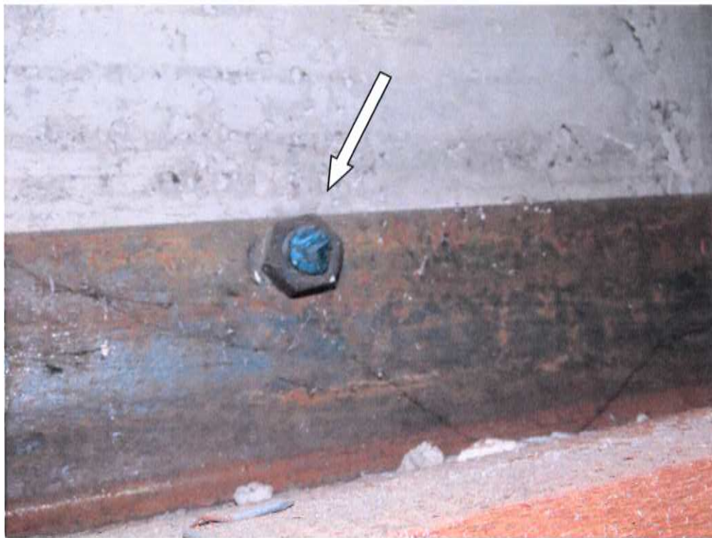
Foto 44: stählernes Lagerprofil: unsachgemäße / mangelhafte Aufhängung des Lagerprofils (unzureichender Randabstand der Schraube)
