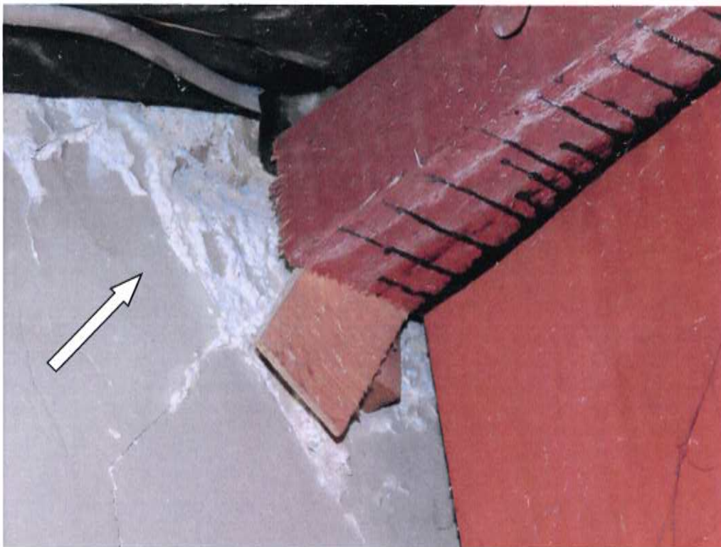
Foto 46: Wände im Dachbereich: flächige Aussinterungen im Bereich von Rissen
