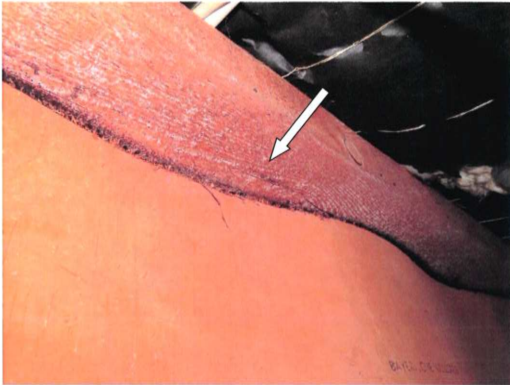
Foto 23: Holz-Wellstegträger: Obergurt mit Längsriss im Wellenbereich der Längsfuge (exemplarisch)
