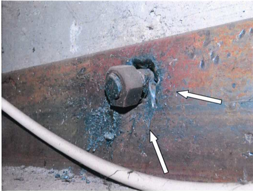
Foto 43: stählernes Lagerprofil: unsachgemäße / mangelhafte Aufhängung des Lagerprofils (ausgebranntes Schraubenloch und teilverschweißte Schraube)
