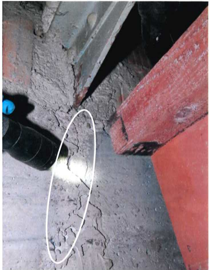
Foto 3: Stahltragwerk: Lagerbereich mit einsetzender Korrosion und Rissbildung
