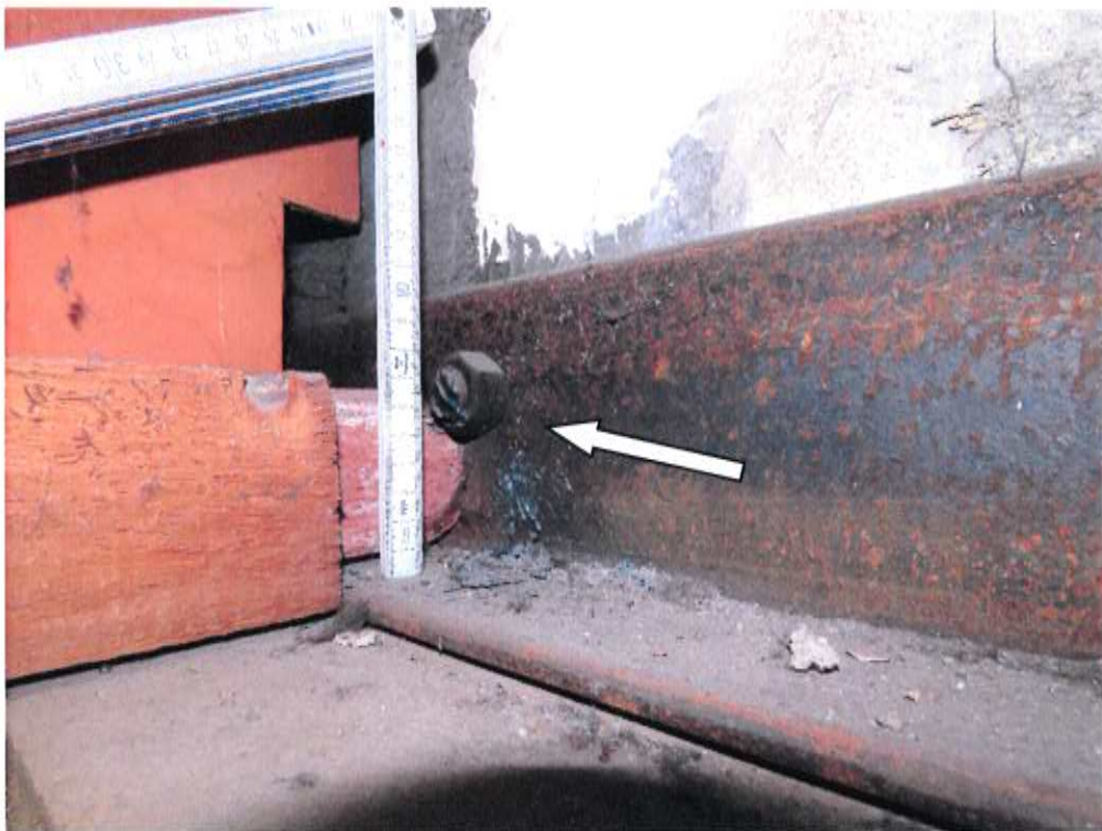
Foto 42: stählernes Lagerprofil: unsachgemäße Aufhängung des Lagerprofils (Hinweise auf ausgebranntes Schraubenloch)
