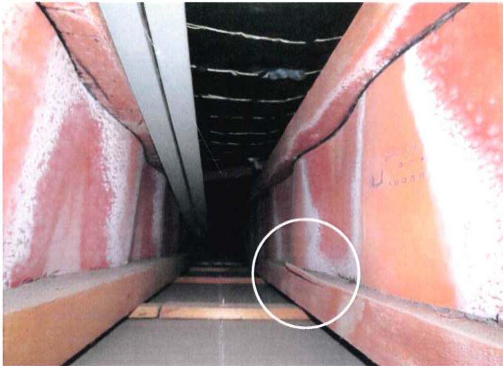
Foto 21: Holz-Wellstegträger: Schadhafter Untergurt (exemplarisch), bereichsweise keine Aussteifung zwischen den Wellstegträgern
