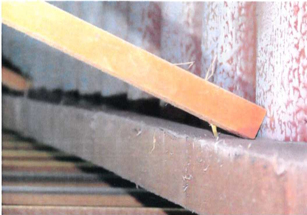
Foto 15: Holz-Wellstegträger: Detailaufnahme zu Foto 14 mit unsachgerechtem Anschluss der Auskreuzung mit einem Nagel
