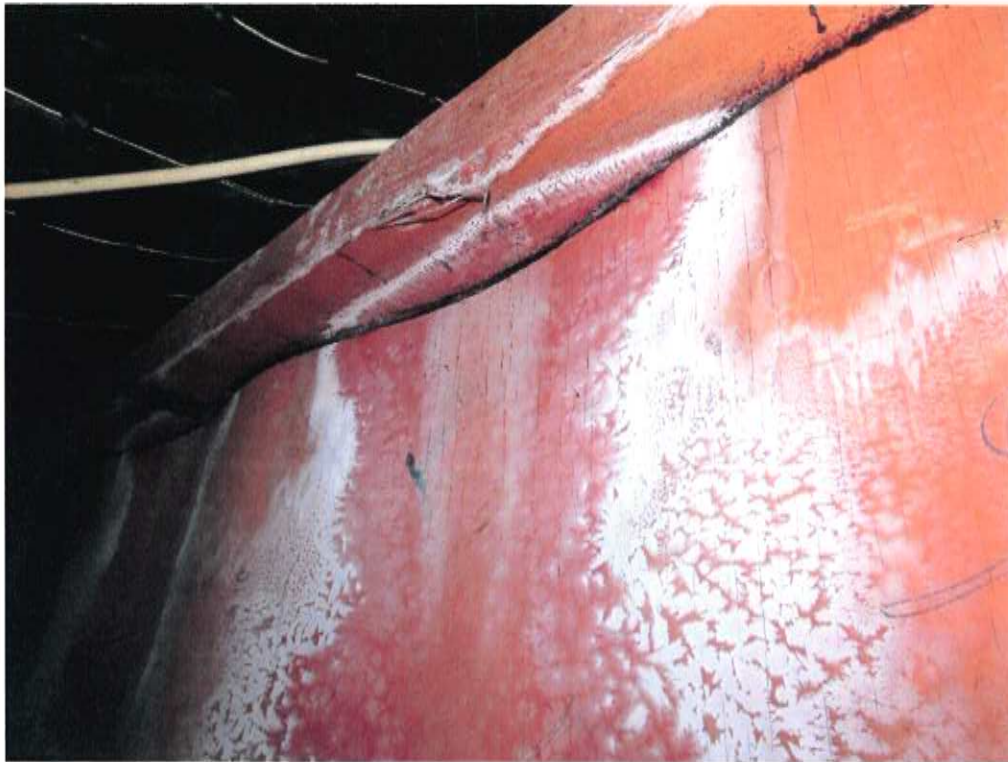
Foto 37: Holz-Wellstegträger: Detail flächige Aussinterungen / Salze auf den Holzoberflächen (exemplarisch)
