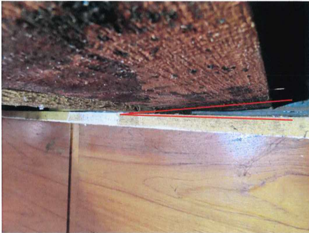
Foto 7: Holz-Wellstegträger: am Untergurt erkennbare Schiefstellung des Trägers
