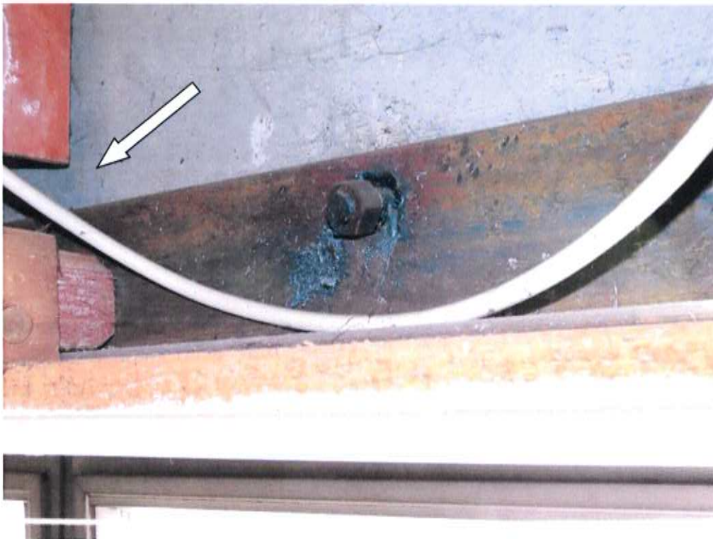
Foto 34: Holz-Wellstegträger: ausgeschnittener Wellsteg im Auflagerbereich und unsachgemäße Aufhängung des Lagerprofils
