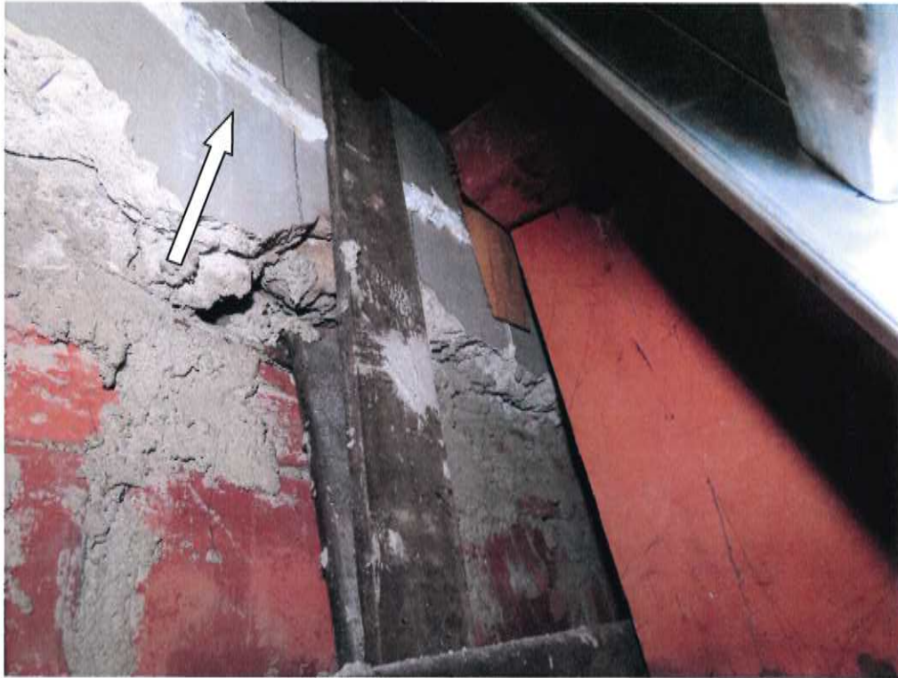
Foto 45: Wände im Dachbereich: Aussinterungen im Bereich von Horizontalriss
