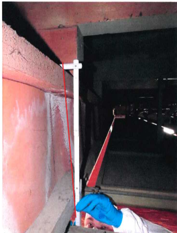
Foto 12: Holz-Wellstegträger: exemplarische Messung der Schiefstellung im Bereich der Bühnentechnik
