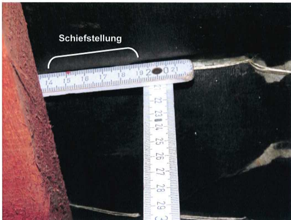
Foto 9: Holz-Wellstegträger: exemplarische Messung der Schiefstellung (> 50 mm bzw. > 6° bezogen auf die Trägerhöhe von 47 cm)
