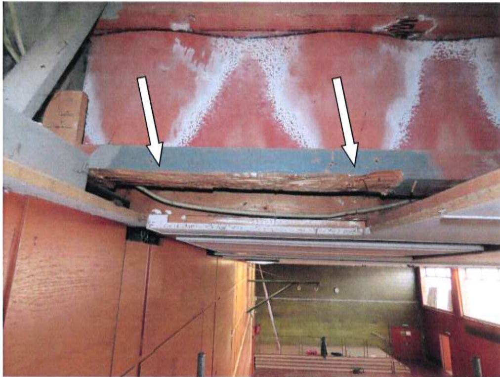
Foto 31: Holz-Wellstegträger: zerstörter Untergurt im Einbaubereich der Leuchten
