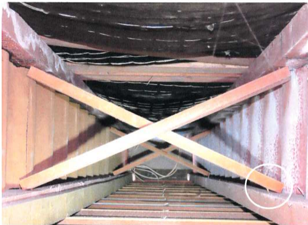
Foto 14: Holz-Wellstegträger: Auskreuzung zwischen Trägern (evtl. als Montage-Provisorium, exemplarisch); exzentrische Aufhängung der abgehängten Decke über je ein seitlich angenageltes Brett (am linken Wellstegträger) erkennbar
