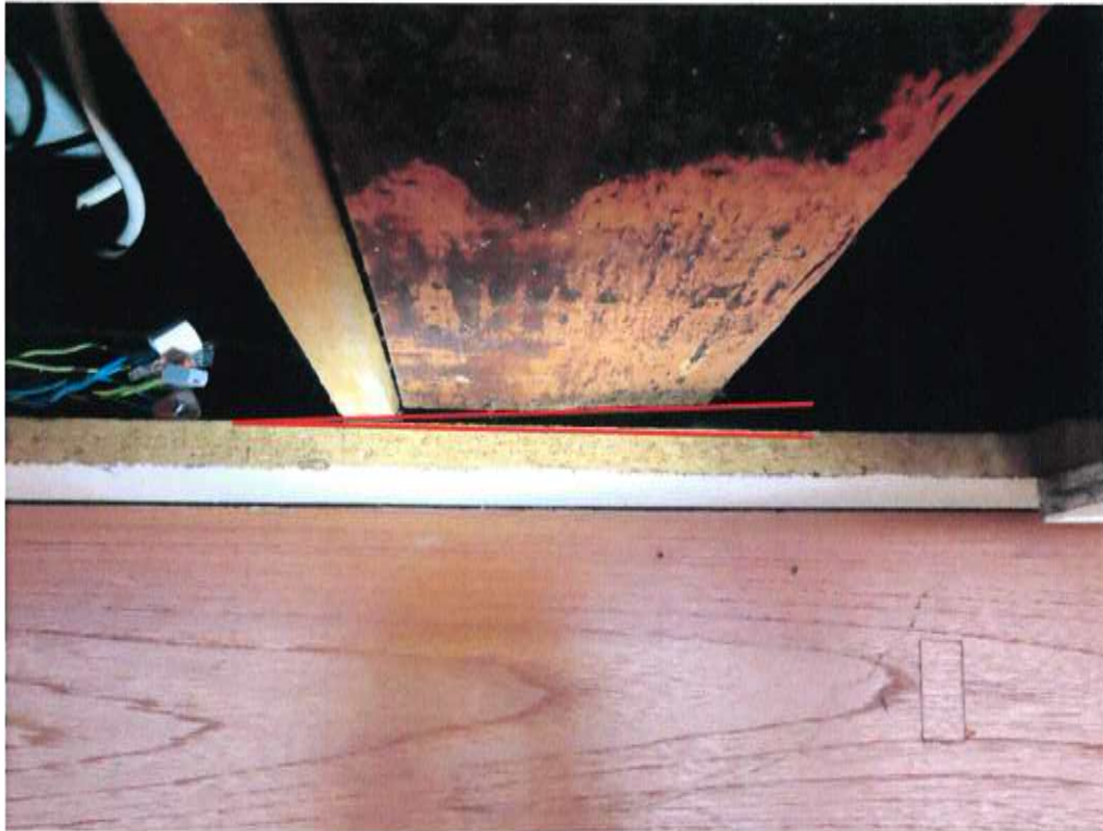
Foto 11: Holz-Wellstegträger: einseitige Aufhängung der Decke am Untergurt und deutliche Schiefstellung des Trägers erkennbar
