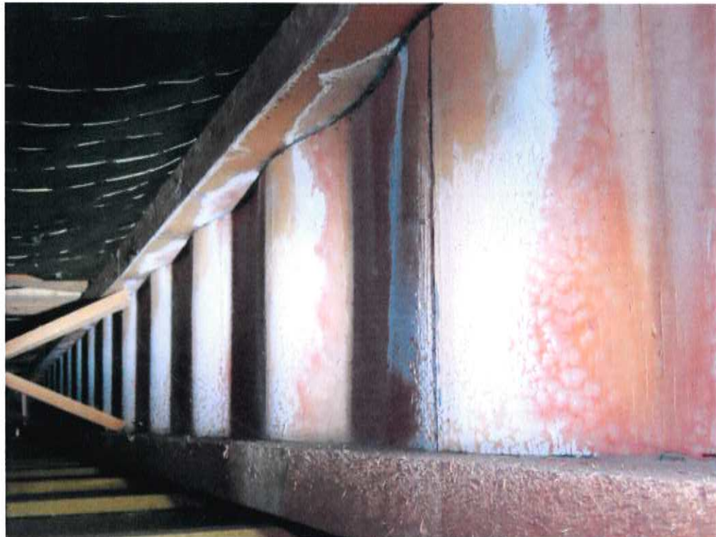
Foto 36: Holz-Wellstegträger: Detail flächige Aussinterungen / Salze auf den Holzoberflächen (exemplarisch)
