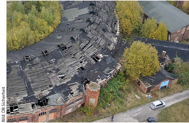
Abb. 10: Schadenserfassung an einem Lok- schuppen
