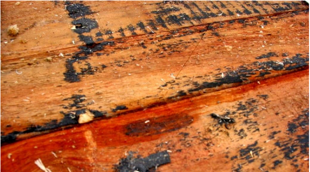
Abbildung 11: "Patschnasse" Holzbretter unter Zinkblech gefunden; Feuchte kann aus ungetrocknetem Holz nicht im verbauten Zustand entweichen
