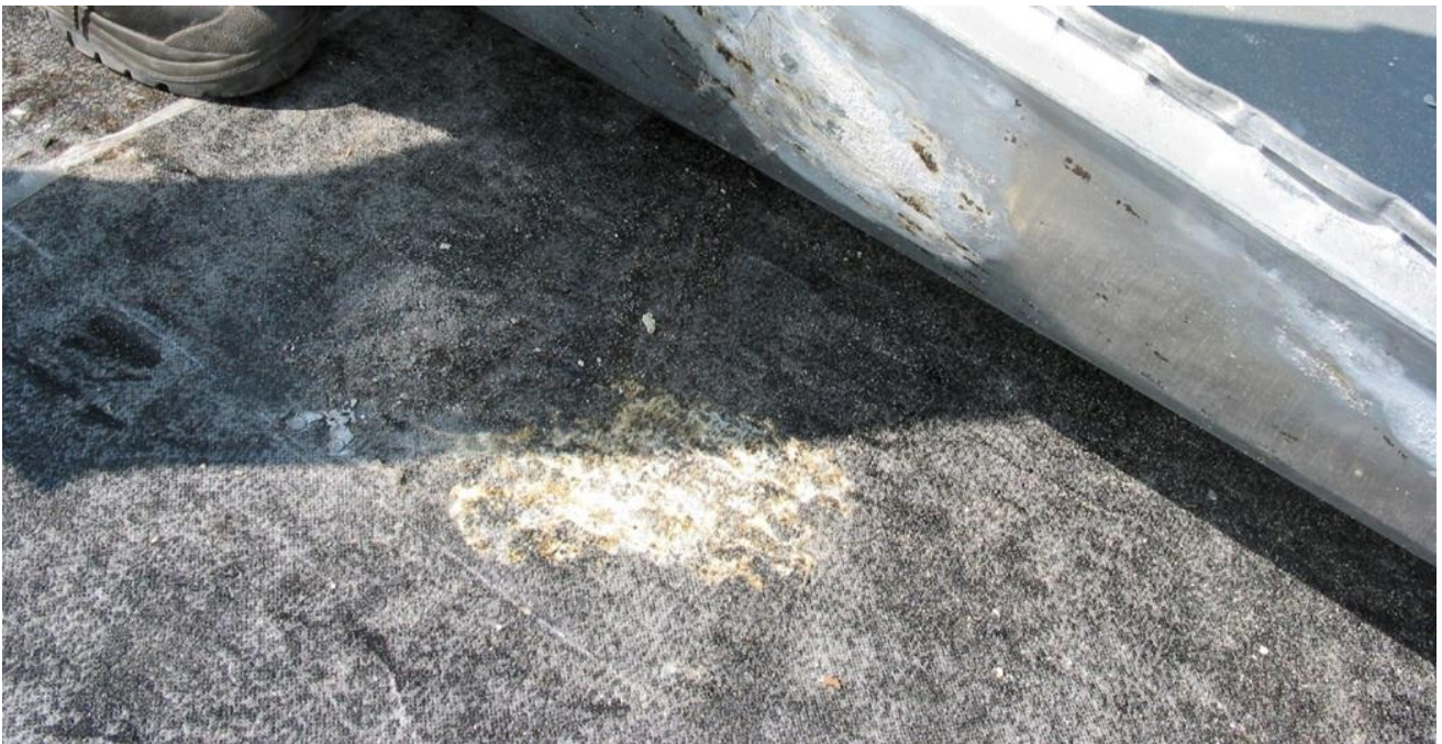
Abbildung 14: Mangelnder Luftaustausch führt zu Korrosion "Weissrost"
