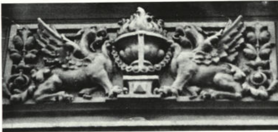
Bild 12: Nordstr. 189: Stuck zwischen Gurtgesims und Fensterbank: Greifen
