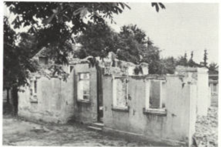
geschütztes Fachwerk-Wohnhaus fast bis auf die Grundmauern abgerissen hatte.
