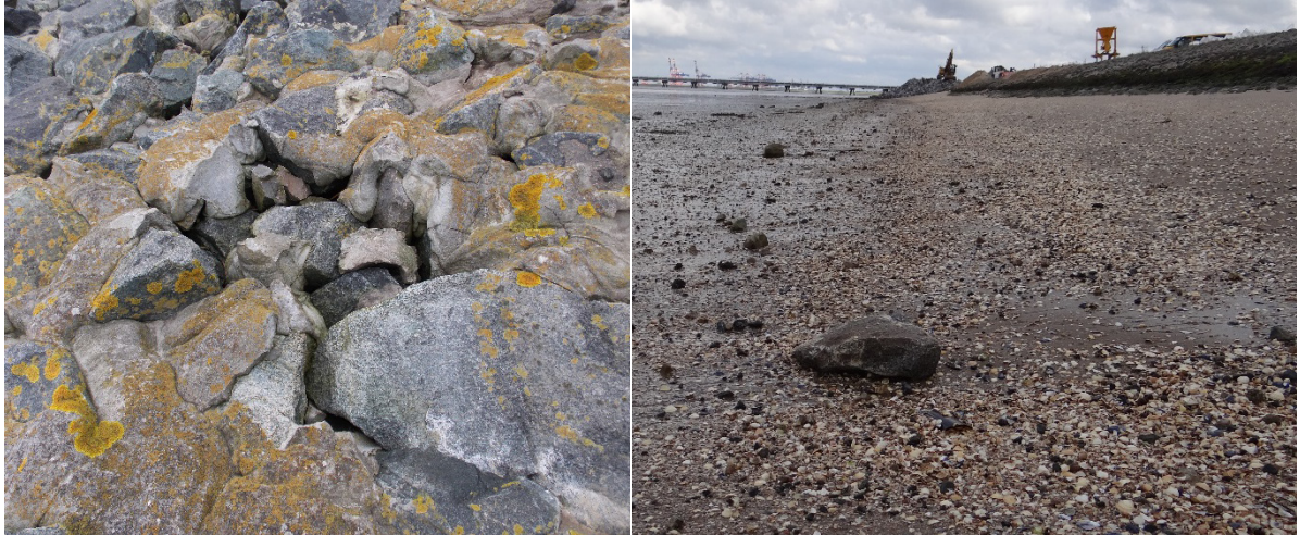
Abbildung 5: Fehlstelle in der Deckschicht aufgrund eines gelösten Einzelsteins (links); gelöster Einzelstein vor dem Deckwerk (rechts) (Fotos: Kreyenschulte 2016).
