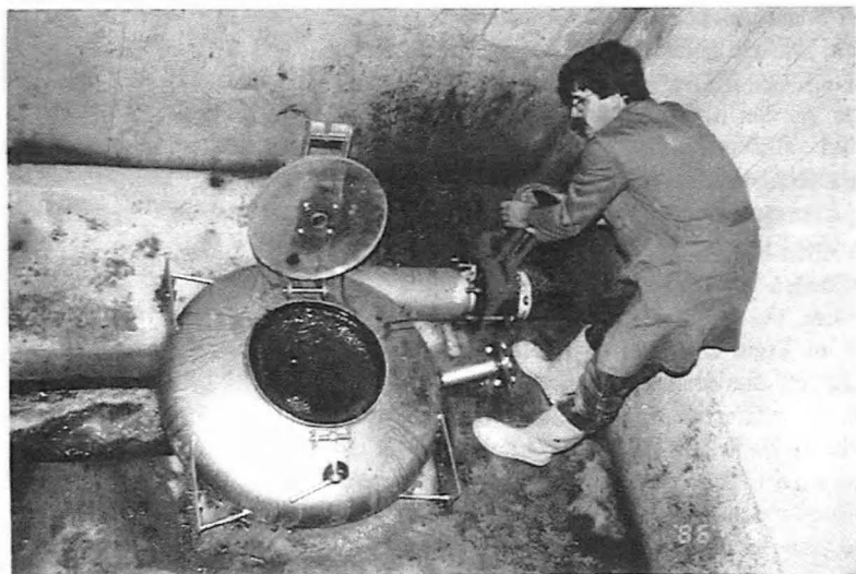
Bild 4: Wirbeldrossel aus Edelstahl als Abflußsteuerung an einem Regenüberlaufbecken
