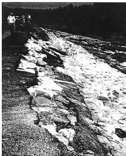
Bild 7: Kanaldamm Oder-Spree-Kanal, Eisenhüttenstadt: Rutschungen auf der Luftseite (Foto: Verfasser)
