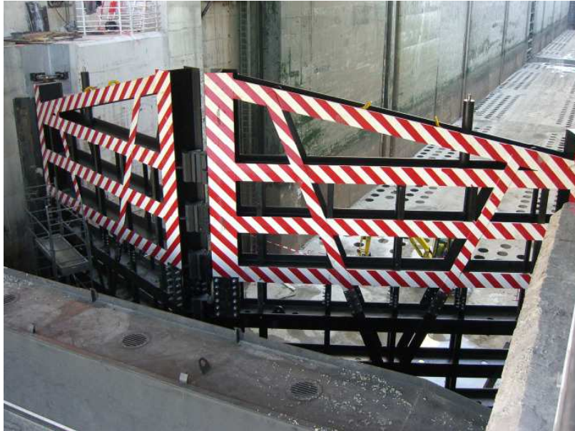
Abbildung 4: Stoßschutz für das Untertor der Schleuse Chateauneuf
