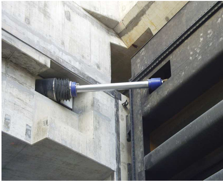
Abbildung 2: Elektroantrieb mit Kopfdichtung, Schleuse Uelzen II
