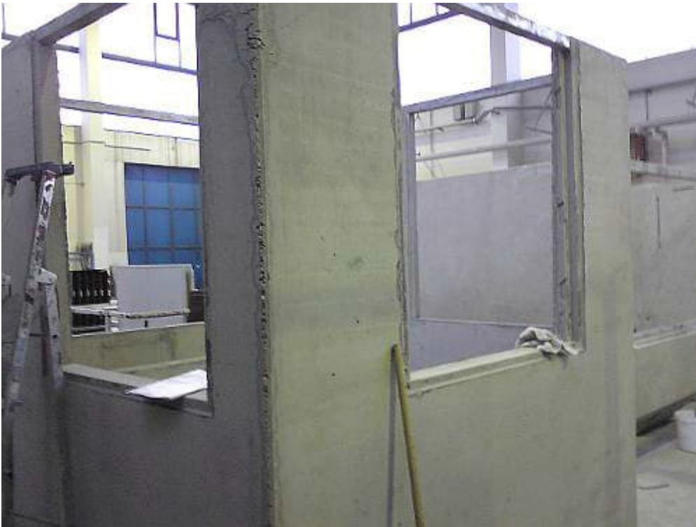
Abbildung 5: Trafostation Fertigteilherstellung mit Chronocrete®
