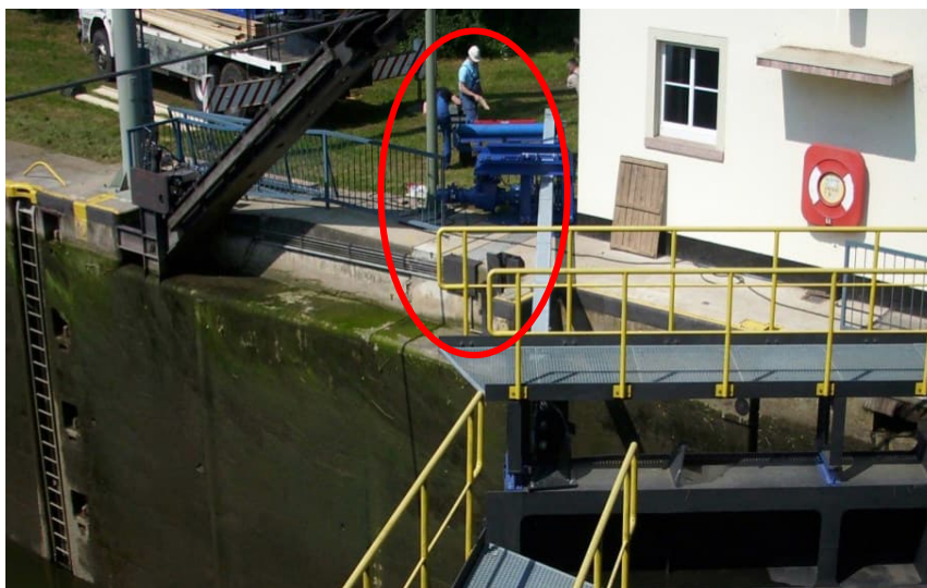
Bild 2: Stemmtor-Hilfsantrieb (Bauart FMM Minden)
