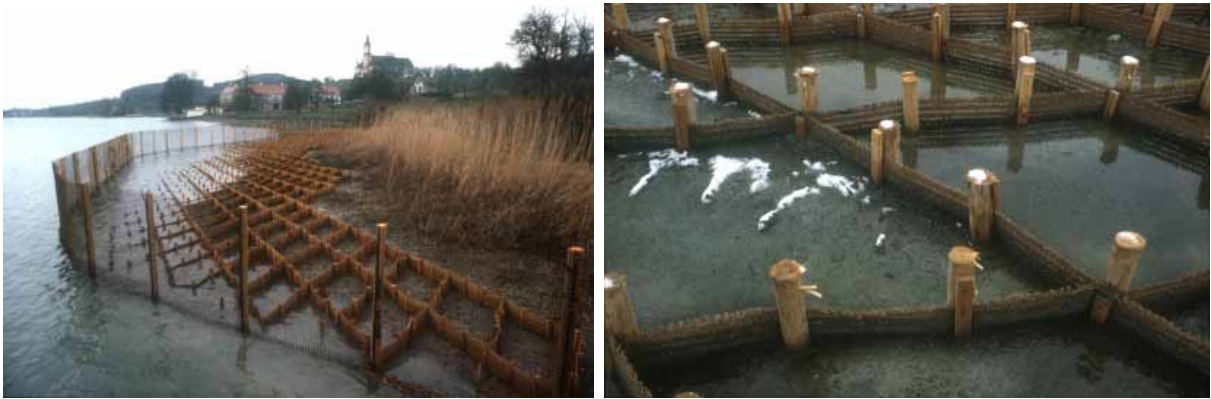
Abbildung 10: Sedimentationskassetten. Links: Anlage zum Schutz eines Schilfbestands, an kurze Pfähle genagelte Bänder aus Kokosgewebe; rechts: Detail, ein Jahr später, einige Kassetten sind mit Sediment verfüllt (Obermaurach, Bodensee-Obersee bei winterlichem Niedrigwasser).
