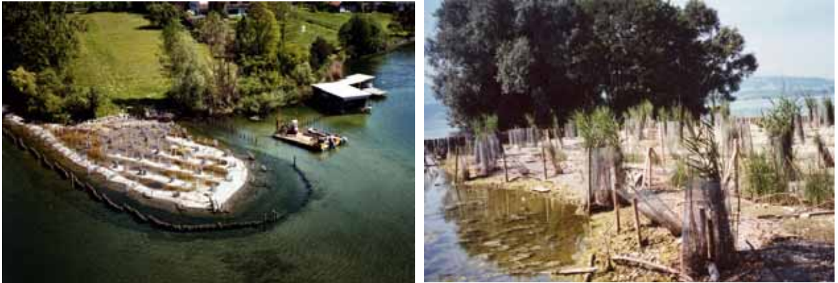
Abbildung 15: Schutz von Schilfpflanzungen auf Renaturierungsflächen. Links: Schilfpflanzung auf einer künstlichen Vorschüttung am Zuger See (Foto: Flying Camera, Baar); rechts: eingezäunte austreibende Schilfbambuspflanzungen (Detail) (Foto: Tiefbauamt Kanton Zug).
