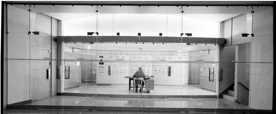
Die Steuerzentrale des Gezeitenkraftwerks etwas ausserhalb der Kaverne, drei Tage nach der Inbetriebnahme.
