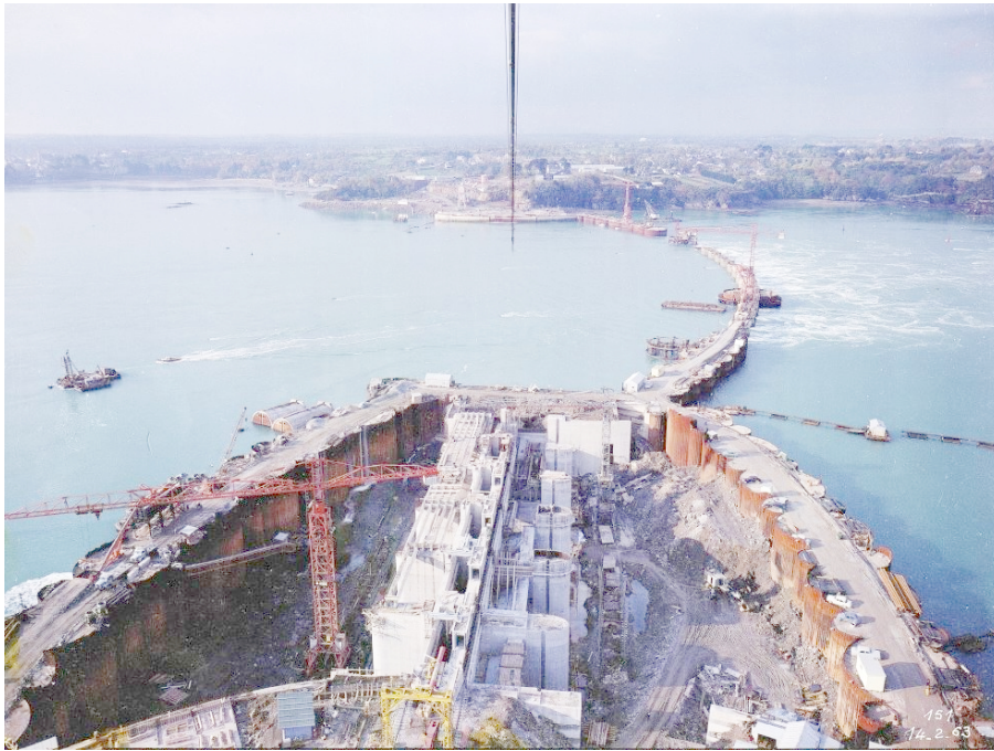
14. Februar 1963, die 6 Tore der Staumauer bei Saint-Malo im Osten waren im Bau. Hinten war ein Teil der Baugrubenumrandung durch die Betonzylinder noch im Bau. Oben sieht man den Kabelkran deutlich. Ein Weitz G 280 HV war an der Arbeit.
