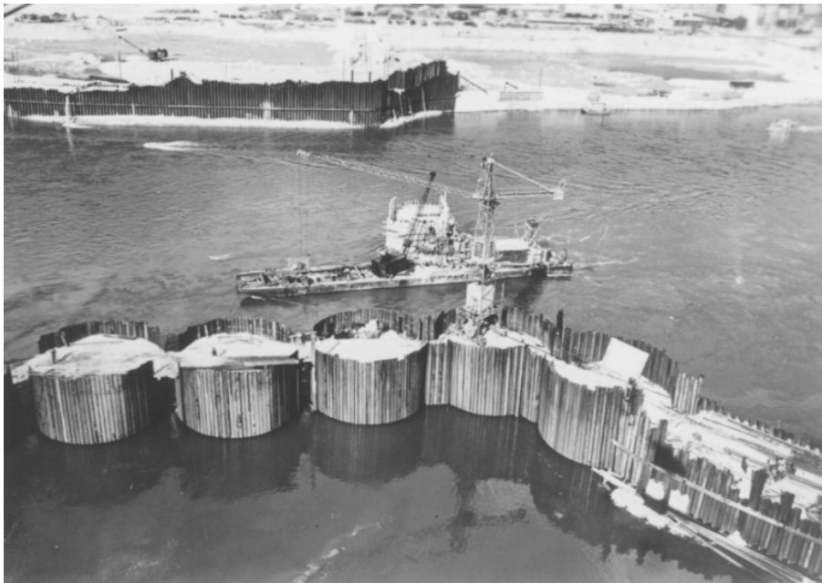
Die Baugrubensicherung durch riesige Betonzylinder war sehr aufwendig und anspruchsvoll und erforderte viel Zeit und sehr viel Beton. Diese waren wegen dem Atlantik notwendig. Hier stand ein Wolff Form 30 auf einem der Betonzylinder.
