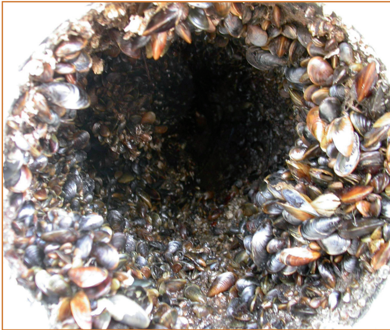
Bild 2: Muschelbewuchs in seewasserführendem Rohr (Foto: TKMS)
