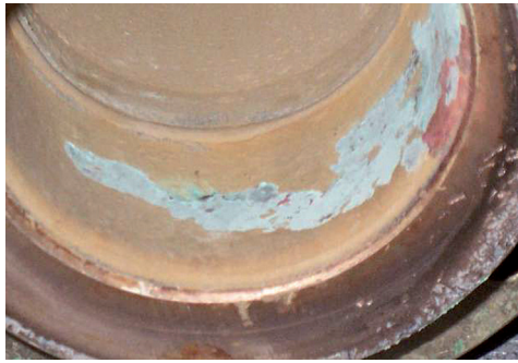
Bild 6: Infolge von Trocknung teilweise abgeplatzte Schutzschicht (Foto: TKMS)
