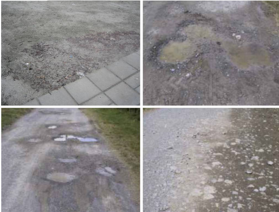
Abbildung 51: Schäden an wassergebundenen Oberfläche nach Starkregen.
