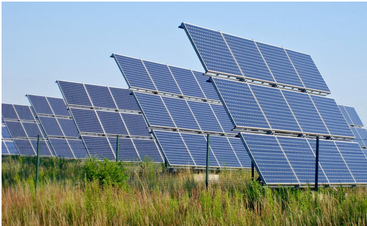
Abbildung 1: Nachgeführte Photovoltaikanlage [Private Aufnahme]
