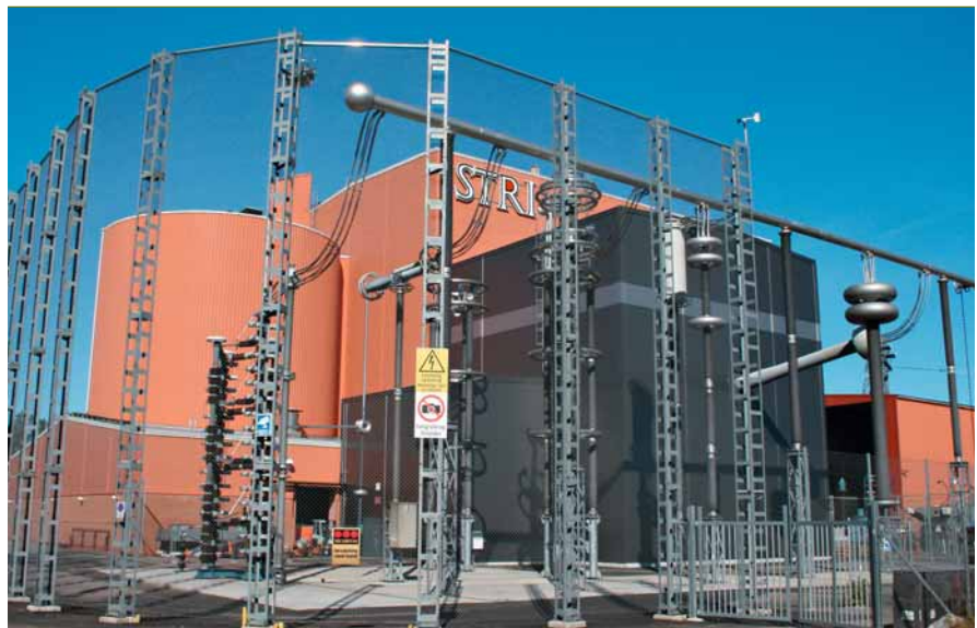
Langzeitprüfung von 800-kV-HGÜ-Anlagen am Hochspannungs-Prüfinstitut STRI in Schweden
