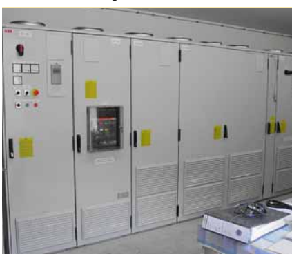
10 Multidrive-Schaltschänke der Gurtförderanlage
