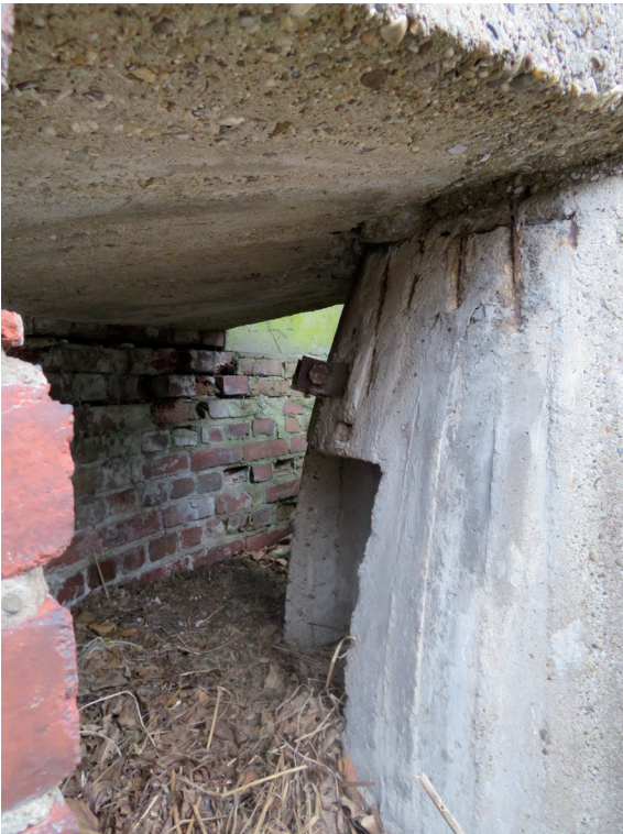
Bild 6: Blick auf den Zugang der Schutzanlage in der Köndgenstraße (Foto: D. Hopp)
