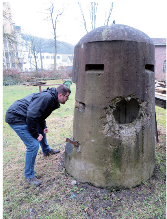
Bild 13: Blick auf moderne Beschädigung (Foto: D. Hopp)
