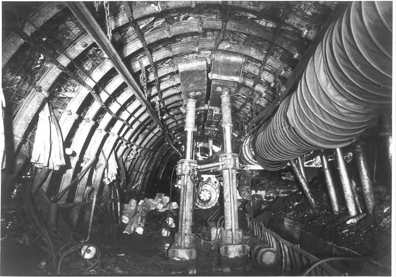
Bild 18 Übergabestation Streb - Strecke in bogenförmigem, nachgiebigem Stahlprofil - Streckenausbau mit 18 qm Streckenquerschnitt. Strebförderer mit Kohlenseiten-Austrag (rechts Mitte). Station mit 60 Mp - Vorziehzylinder für Streckenpanzer-Förderer mit geschlossenem Untertrum.
