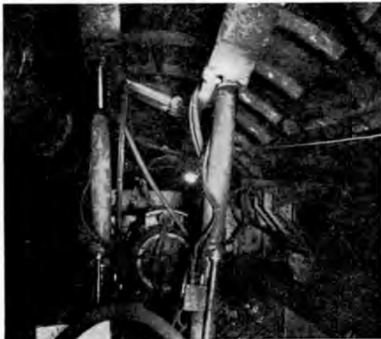
Abb. 1. Hydraulische schreitende Übergabestation mit seitlichem Kohlenaustrag in einer Fußstrecke der Zeche Zollverein.
