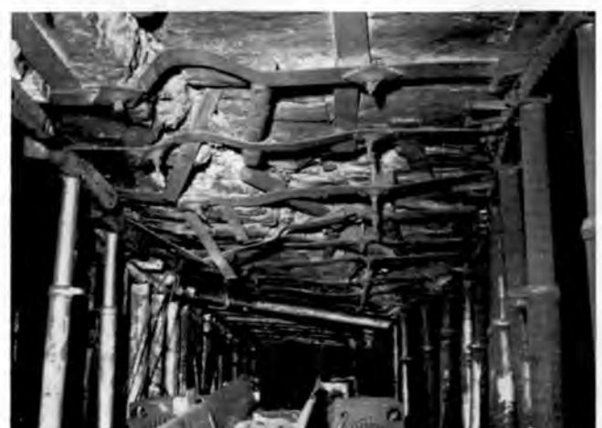
Bild 12. Anker-Türstock-Ausbau im Bereich einer Störung mit 0,4 m Verwurfs-höhe, 35 m nach Streburchgang. Die Schäden am Verzug stammen vom Kappenzug einer hydraulischen Übergabestation Streb-Strecke.
