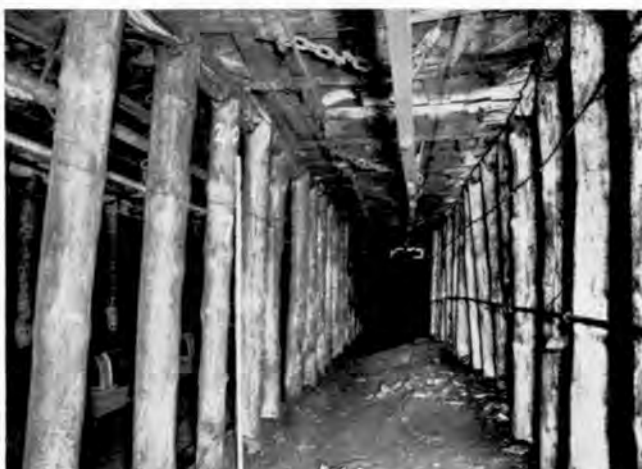
Bild 11. Die Anker-Türstock-Strecke in Flöz Ernestine unter Abbaukanten im Hangenden, mit aufgebrochener Streckensohle.
