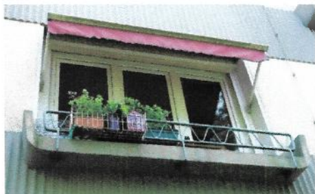
Fenster mit Blumenbank – bauzeitlich: Tragkasten mit Geländer für Blumenschmuck, Metallrahmen der ursprünglichen Fenster mit Jalousie, Putzoberflächen – nicht bauzeitlich: Kunststofffenster, Farbfassung der Putzflächen
