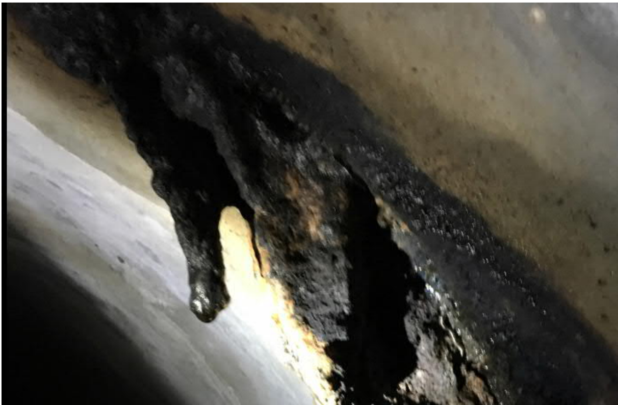
Abbildung: Aussinterung im Scheitelbereich an Fugen des Grundablasskanals
