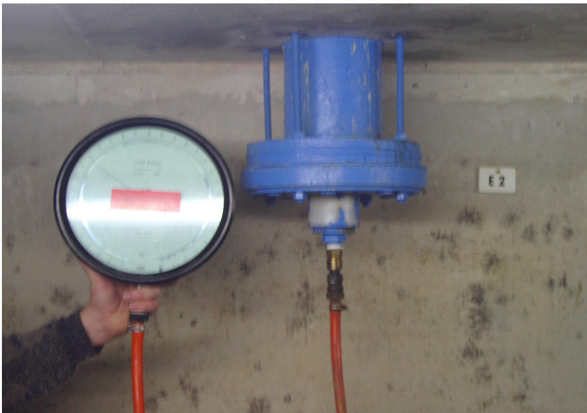
Abbildung: Wasserdruck – Messstelle im Entnahmebauwerk
