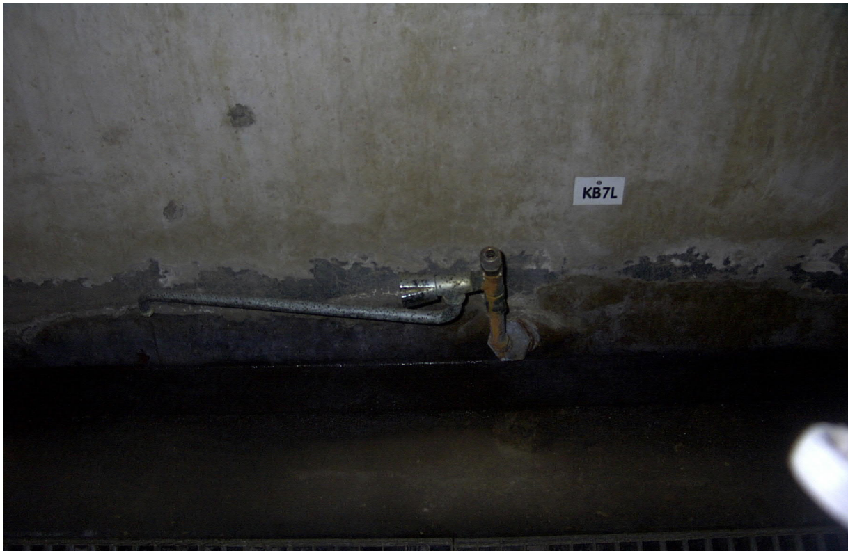
Abbildung: Sohlenwasserdruck – Messstelle KB7L mit Manometer – Schnellschlussadapter
