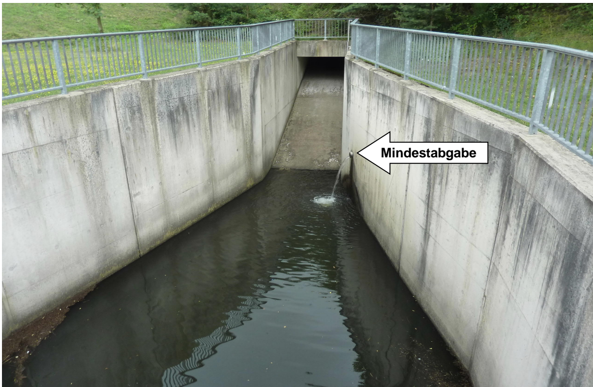
Abbildung: Hochwasserentlastungsanlage außer Betrieb
