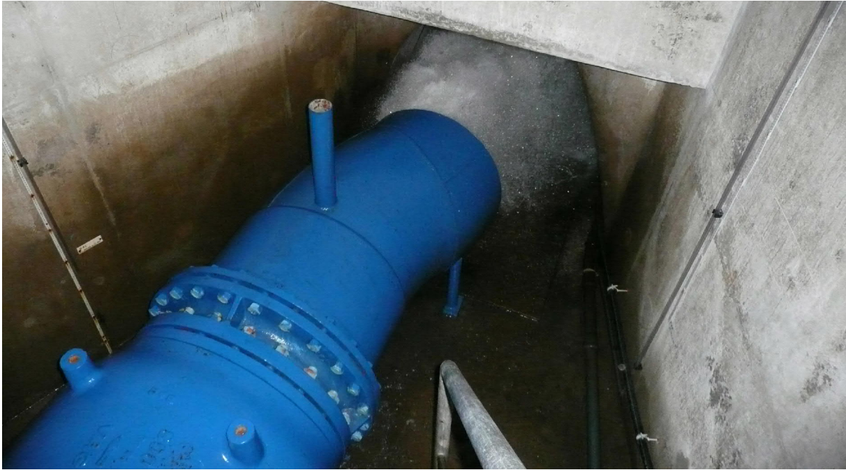
Abbildung: Grundablass in Betrieb
