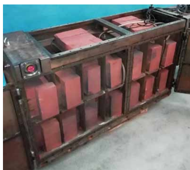
Rys. 7. Widok wypełnienia wnętrza komory skrzyni akumulatorowej [7]
