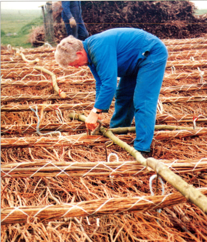
foto 32: Kruisconstructie in het bovenrooster, de sleeptros is deels zichtbaar.
