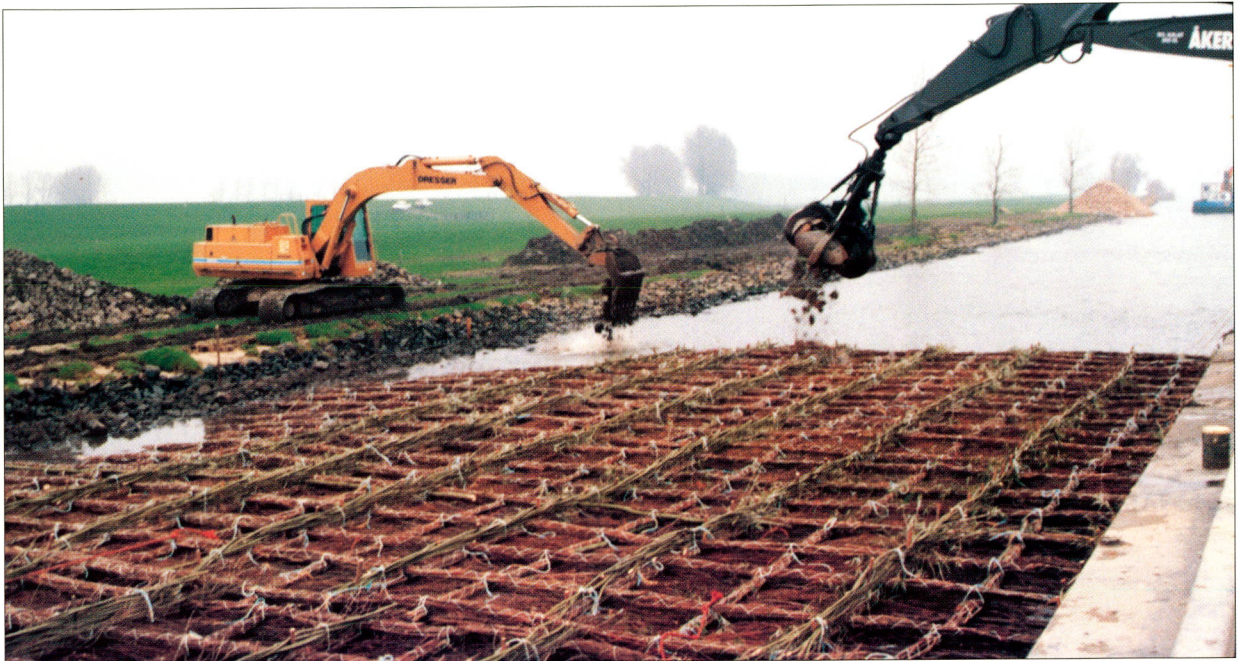
foto 36: Met behulp van een kraan op de oever en een kraan op de ponton langsij het kraagstuk wordt het zinkstuk in benedenstroomse richting afgezonken.
